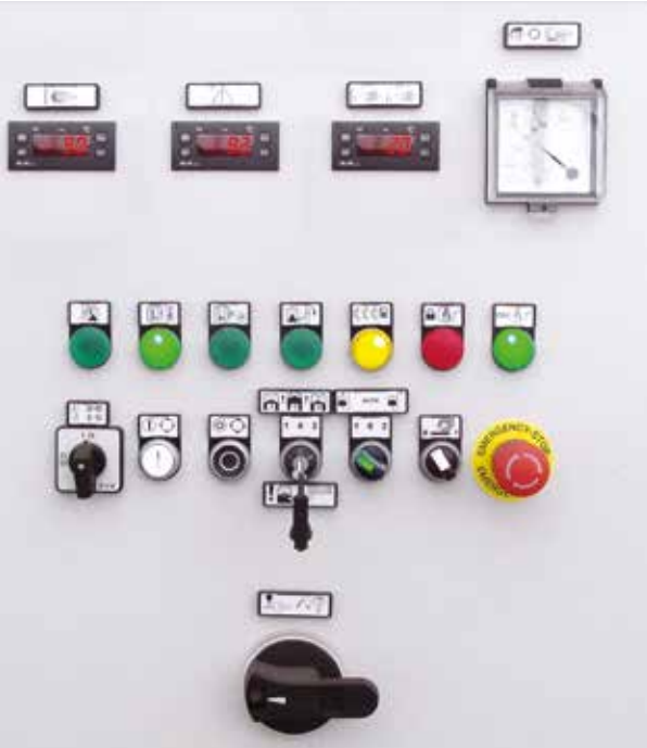
Stationary electrical panel with working devices Стационарная электрическая панель
